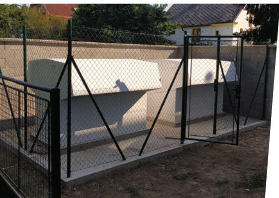
Centrální čerpadlo vzduch–voda s novou otopnou teplovodní soustavou na v MŠ Slatiāny Central air–water pump with a new heating and hot water system at NS Slatiāny
