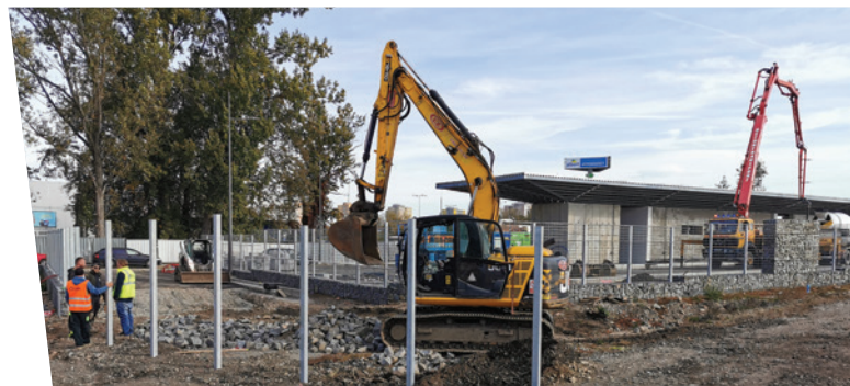
Průběh stavebních prací na novém Terminálu B Construction works at the new Terminal B
